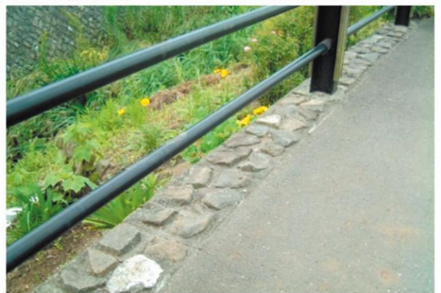
天端部分の不明瞭な仕上げ
