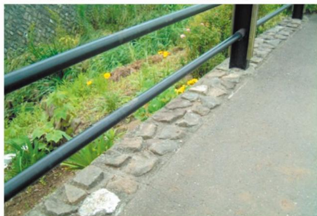
天端部分の不明瞭な仕上げ
