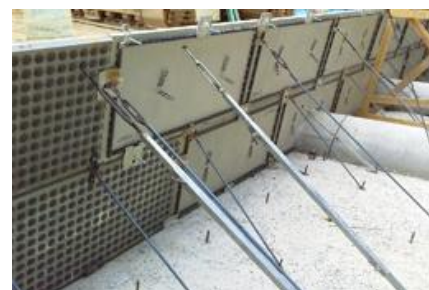
3. 専用勾配調整サポート使用状況
